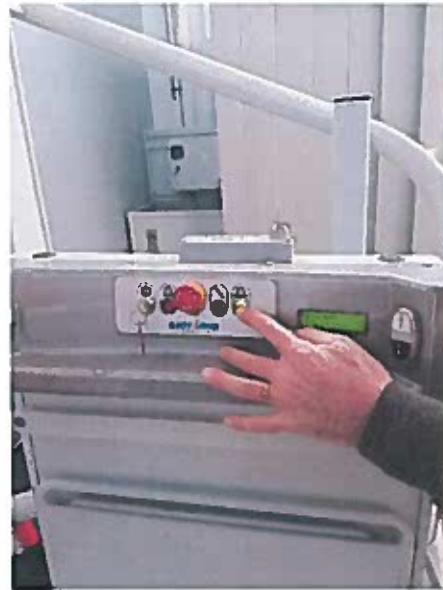
Foto 2: Vista posizione comandi centrali
